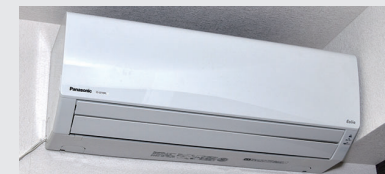
全居室エアコン付
